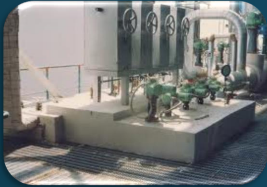
Hydro Power : 230 MW
