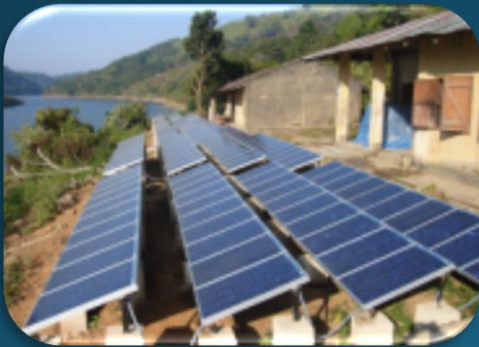
Solar PV: 200 MW
